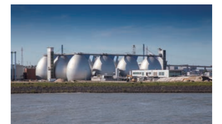
下水処理場における創エネルギー：下水汚泥を活用した消化ガス発電設備
