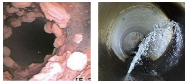
老朽化が進む管路施設 錆が発生している水道管(左)と地下水が浸入する下水道管(右)
