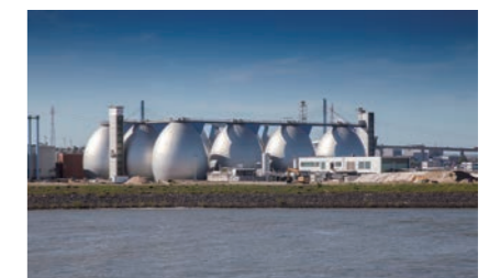
下水処理場における創エネルギー：下水汚泥を活用した消化ガス発電設備
