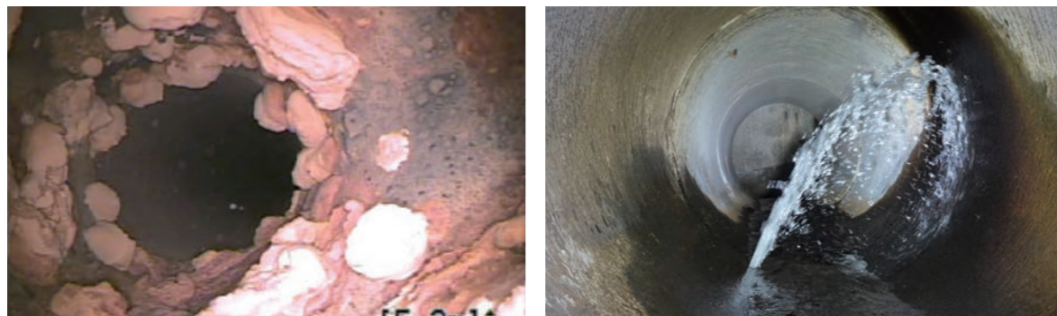
老朽化が進む管路施設：錆が発生している水道管（左）、地下水が浸入する下水道管（右）
