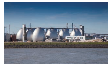
下水処理場における創エネルギー： 下水汚泥を活用した消化ガス発電設備
