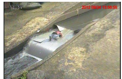
図-5 管内発電装置の運転状況
