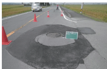
マンホール浮上
