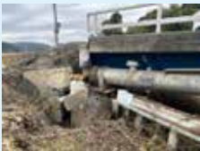
能登半島地震で被害を受けた水道施設
