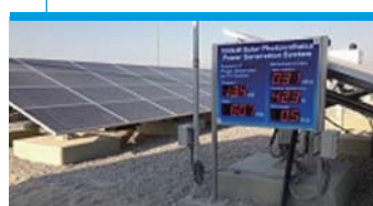
パレスチナ国ジェリコ市下水処理場に 導入されたソーラーパネル 建設 2011~2014
