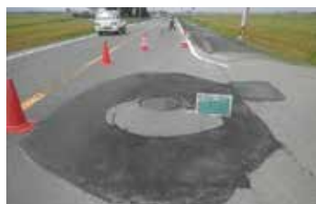
マンホール浮上
